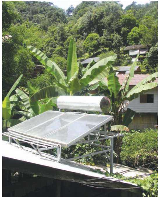
เครื่องทำน้ำอุ่นพลังแสงอาทิตย์บนหลังคาบ้านพรหมมินทร์
