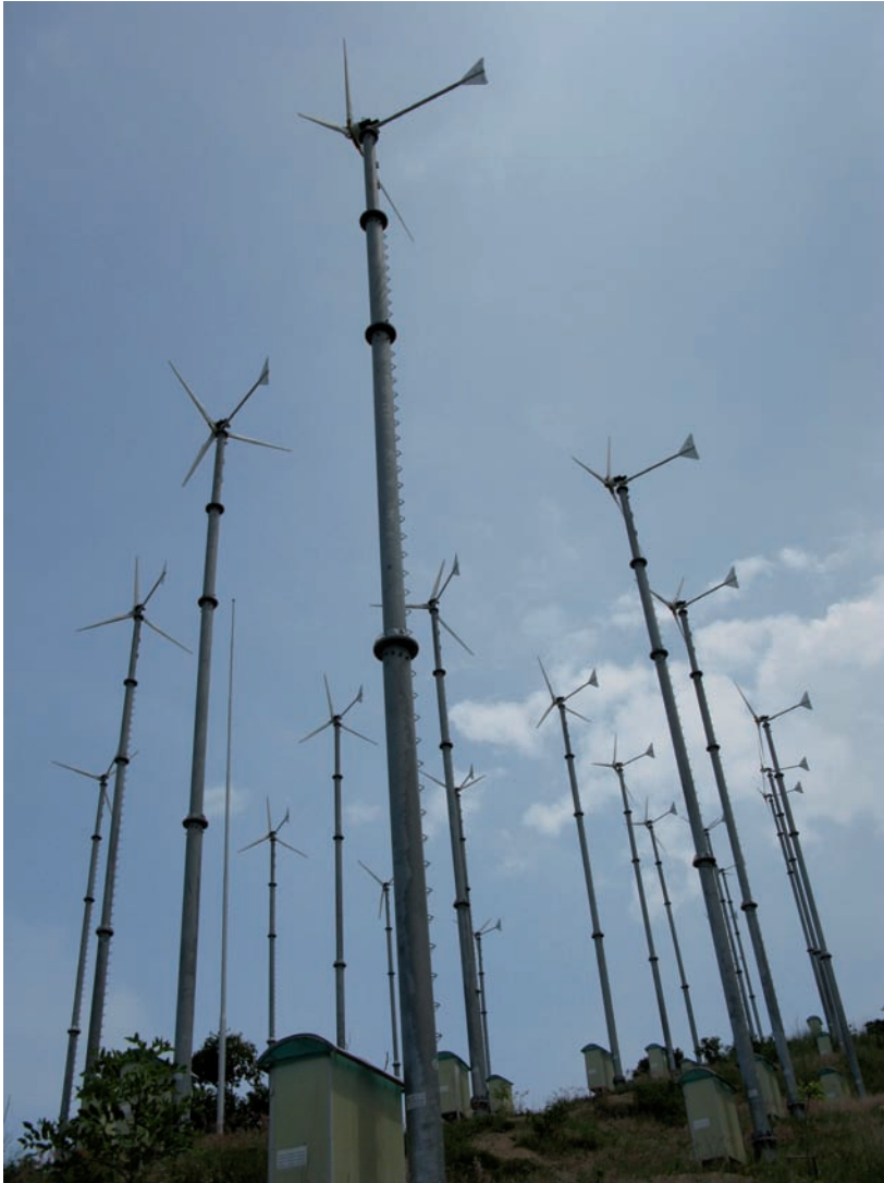
ฟาร์มกังหันลมบนเกาะล้าน สร้างขึ้นเพื่อผลิตไฟฟ้าใช้ ในสาธารณูปโภคบนเกาะ
