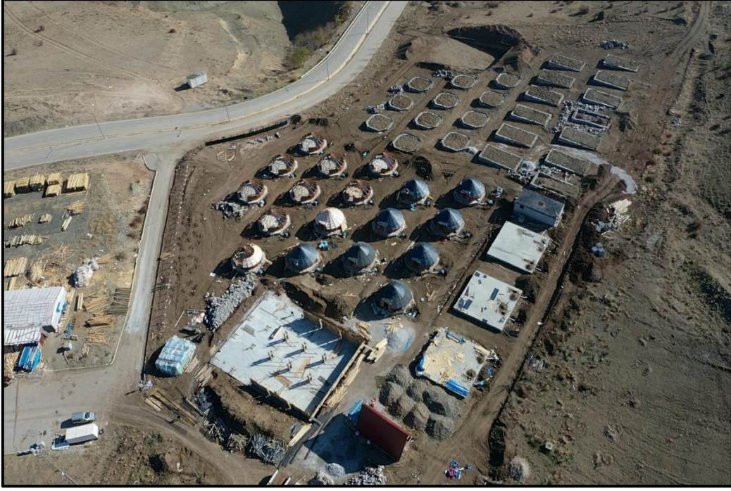
Foto 3. Teleferik (gondol) başlangıç sahası yanında inşa edilmekte olan 50 adet çadır tipi bungalovlar.
