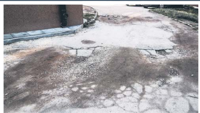
UL. MATEJKI 20. WYRWY W DRODZE DOJAZDOWEJ
