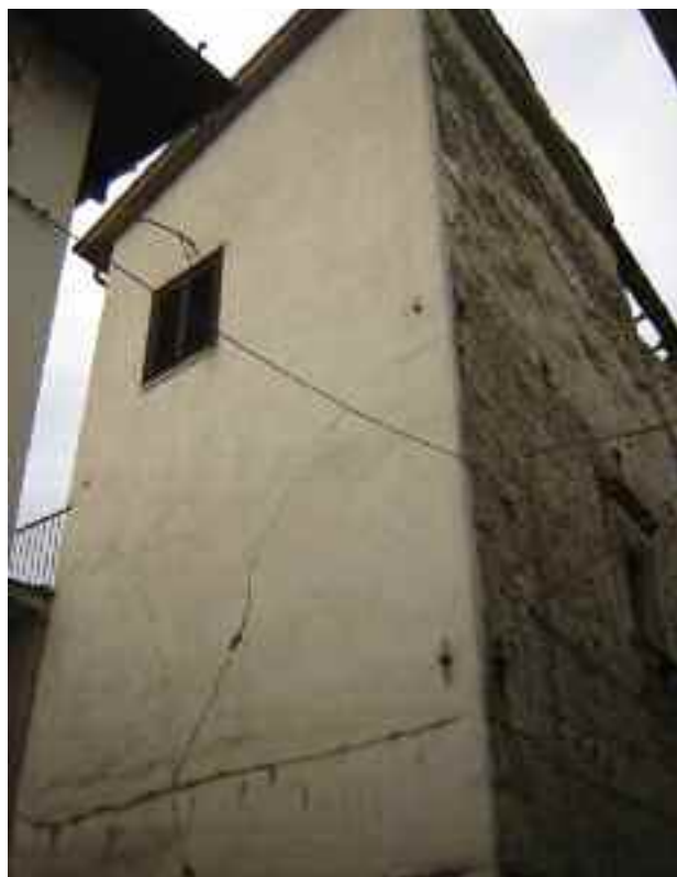
2. Paganica (L'Aquila). Ribaltamento fuori piano (meccanismo di primo modo) della porzione sommitale di una sopraelevazione recente confrontata con il comportamento scatolare della parte sottostante garantito da presidi antisismici efficaci.
