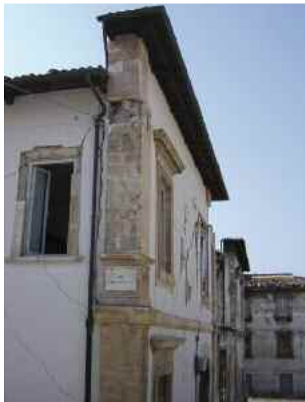
1. L'Aquila. Le lesioni diagonali (meccanismo di secondo modo) su entrambe le pareti esterne di un edificio, prospettante sulla piazza San Pietro di Coppito, dimostrano il comportamento scatolare dell'assemblaggio murario corredato di presidi sistematicamente disposti nella sua compagine.
