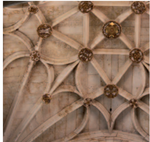
4. Detalle bóveda en la que se aprecia que, entre las claves sólo hay sitio para una pieza.
