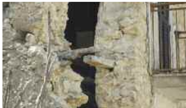
8. Villa Sant'Angelo (L'Aquila). Connessione angolare a mezzo legno tra i radiciamenti di due pareti ortogonali senza ancoraggi metallici esterni.
