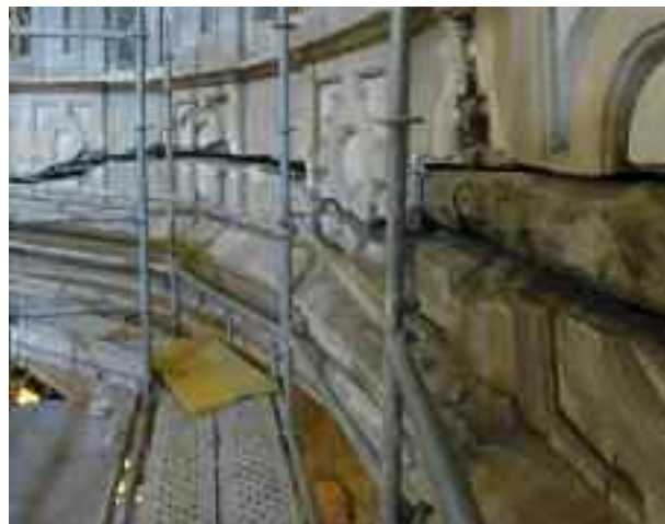
10. Calatayud (Zaragoza). Colegiata de Santa María, detalle del arranque del tambor de la cúpula, durante las obras de consolidación de 2014. La grieta horizontal delata la existencia del encadenado lúneo original, que se evidencia en la cata que se observa en primer término.
