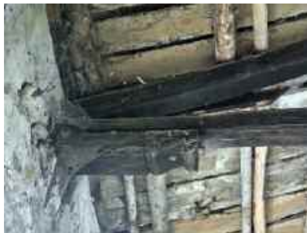
11. Fossa (L’Aquila). Vista dall’interno della mensola d’appoggio di una capriata di copertura ancorata esternamente con un paletto ligneo (impalettatura).
