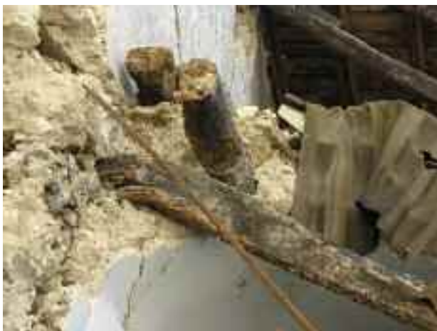
10. Villa Sant’Angelo (L’Aquila). Volta a botte rinforzata con elementi lignei tra loro ortogonali e immersi nella ghiera muraria della volta e nello spessore della parete di facciata (qui crollata).
