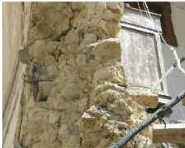
4. Villa Sant'Angelo (L'Aquila). La evidente alterazione della tecnica settecentesca (taglio del radicamento ligneo) denuncia il venir meno della consapevolezza del pericolo sismico.
