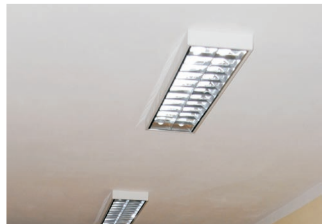
Podczas remontu w szkole wymieniono oświetlenie w całym budynku. W sumie wstawiono 1021 nowych lamp
