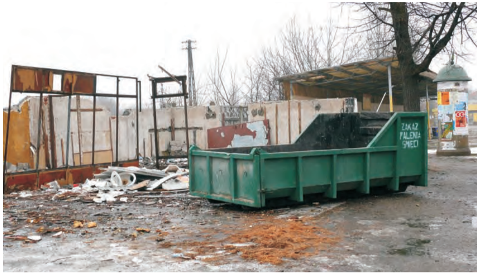
Sterta śmieci i resztki rozebranego budynku witały przez kilkanaście dni podróżnych schodzących z kładki nad torami przy dworcu PKP Łowicz Główny
